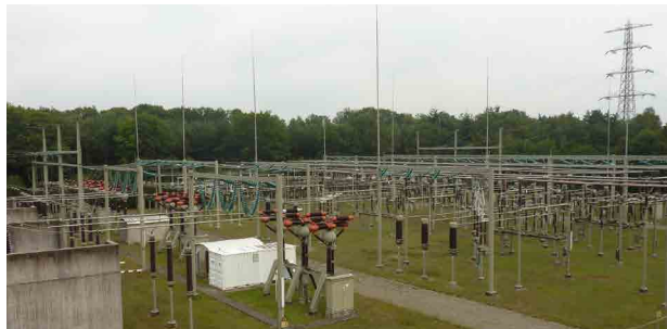
HS-TS station (van 110-150 naar 25-66 kV)
