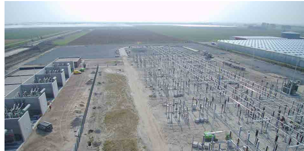
HS-MS station (van 110-150 naar 3-23 kV)
