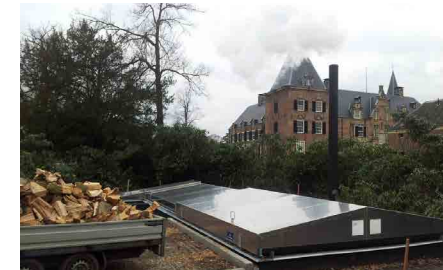
biomassaketel op lokaal (snoei)hout
