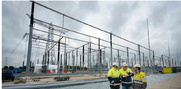
EHS-HS station (van 220-380 naar 110-150 kV)
